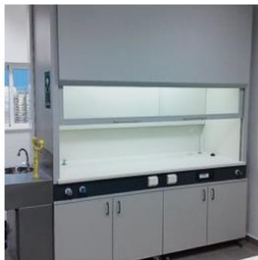
Hottes com sistema de extracção para o exterior
